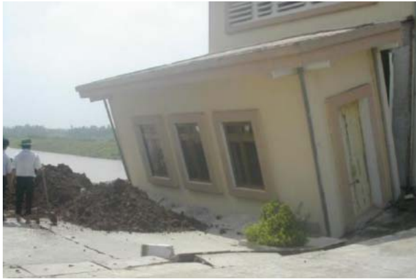
Hình 4. Sập gian điều hành cống Tắc Giang do xói ngầm
