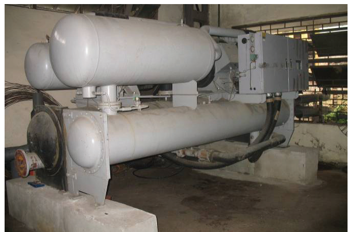
Chiller IFW-SR250D chế tạo tại xưởng thử nghiệm Viện IMI
