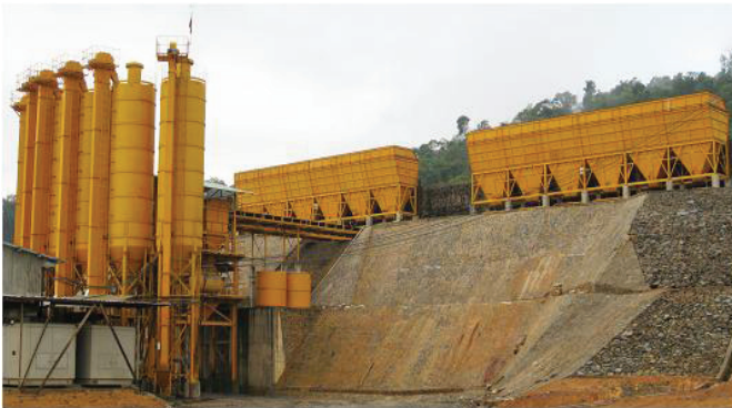
Hệ thống trạm trộn bê tông dự lạnh công suất 360 m 3 /h lắp đặt tại Thủy điện Đồng Nai 4
