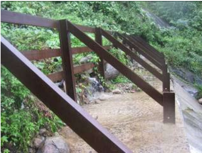
Hình 2: tường kết cấu thép chặn đá lăn tại Km 906+950, quốc lộ 1 A trên đỉnh đèo Hải Vân
