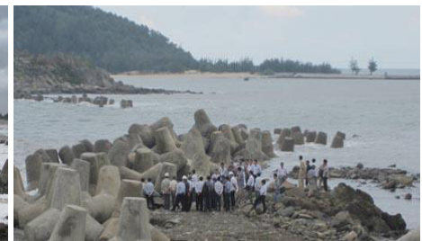
Hiện trạng tuyến đê sau khi bị vỡ
