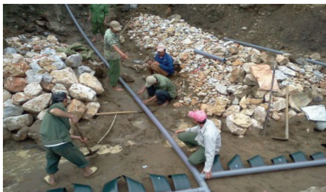
Thi công công trình đầu mối cấp nước sinh hoạt bằng công nghệ đập ngầm tại xã Chăn Nưa - Lai Châu
