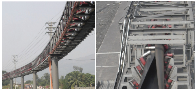
Băng tải ống vận tải than do TKV chế tạo, lắp đặt tại Công ty than Mạo Khê
