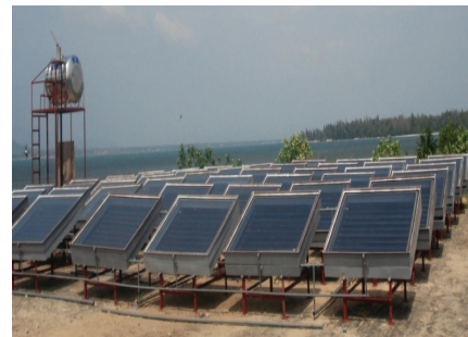
Thiết bị lọc nước biển thành nước ngọt được lắp thử nghiệm tại Cam Ranh - Khánh Hòa
