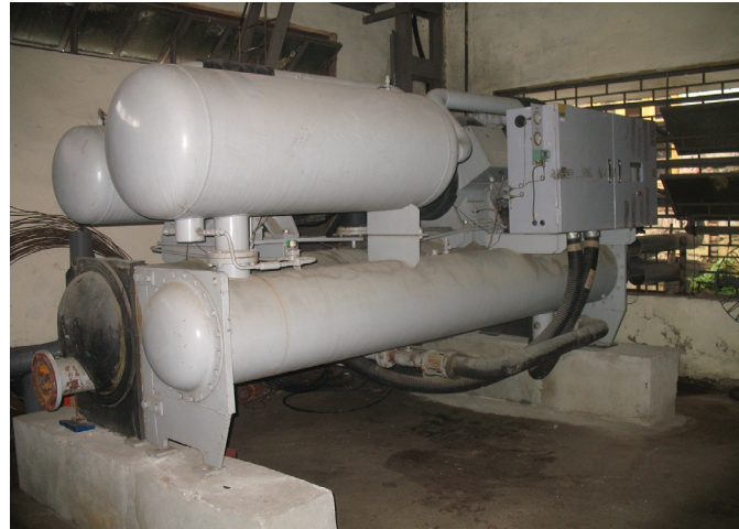
Hình 2: Chiller IFW-SR250D do IMI thiết kế, chế tạo
