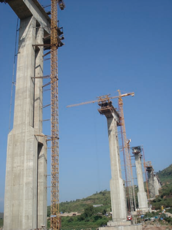
Cầu Pá Hôn (Sơn La) - Cây cầu có trụ cao nhất Việt Nam (98,6 m) và nhịp dầm chính dài 130 m
