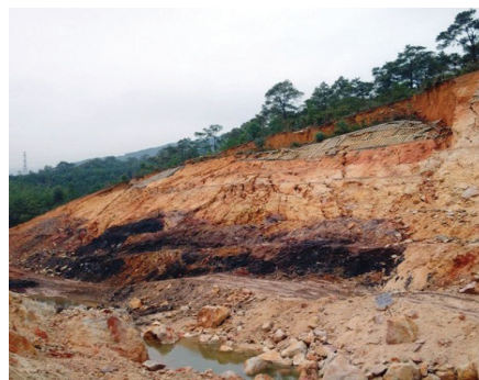
Hình 1. Trượt đất tại Km9-Km10 khi thi công cao tốc Hạ Long - Vân Đồn (2016).
