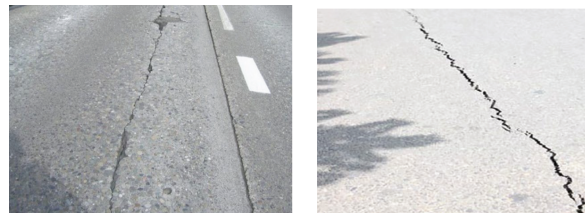
Hình 6. Nứt dọc và nứt ngang tuyến đường hiện trạng
