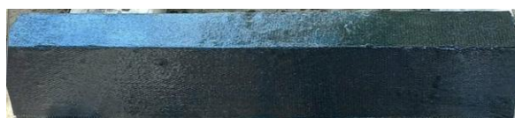
Hình 16. Lăn phủ lớp keo epoxy TCK 510R lần 2 lên bề mặt các dầm
