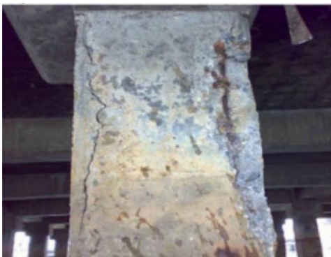
a) Bê tông bị ăn mòn
