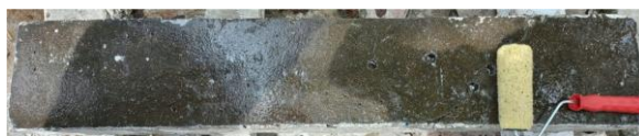
Hình 12. Lăn phủ lớp keo epoxy TCK 510P lên bề mặt các dầm
