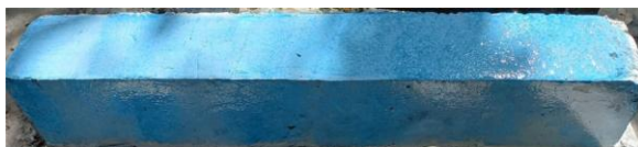
Hình 14. Lăn phủ lớp keo epoxy TCK 510R lên bề mặt các dầm
