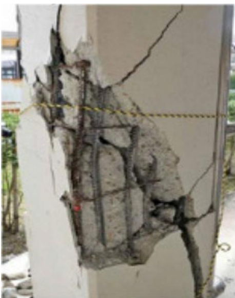
b) Bê tông bị phá hoại
