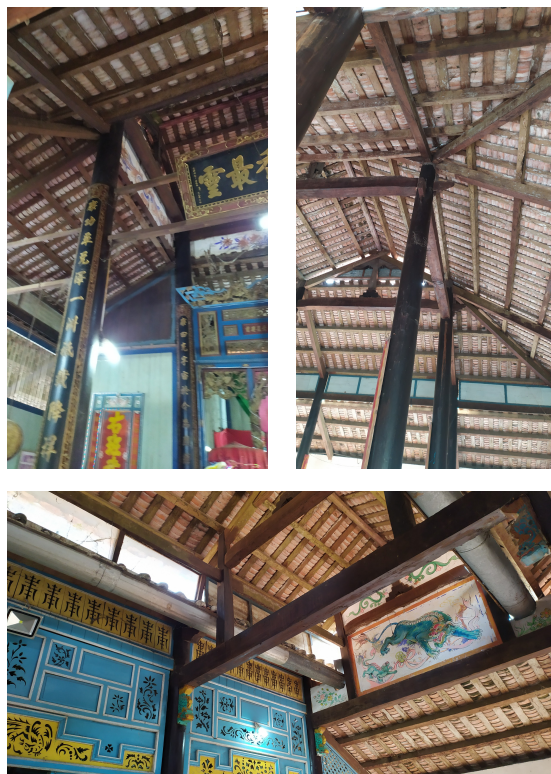
Hình 12. Từ trái qua Hệ kết cấu Chính điện - Võ Ca - Võ Qui Long khương miếu, Hồng Ngự, Đồng Tháp
