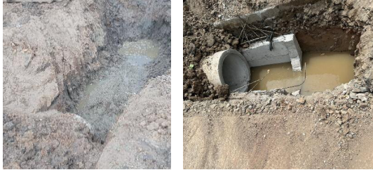
a) Sạt lở taluy hố đào b) Hố đào bị đọng nước
