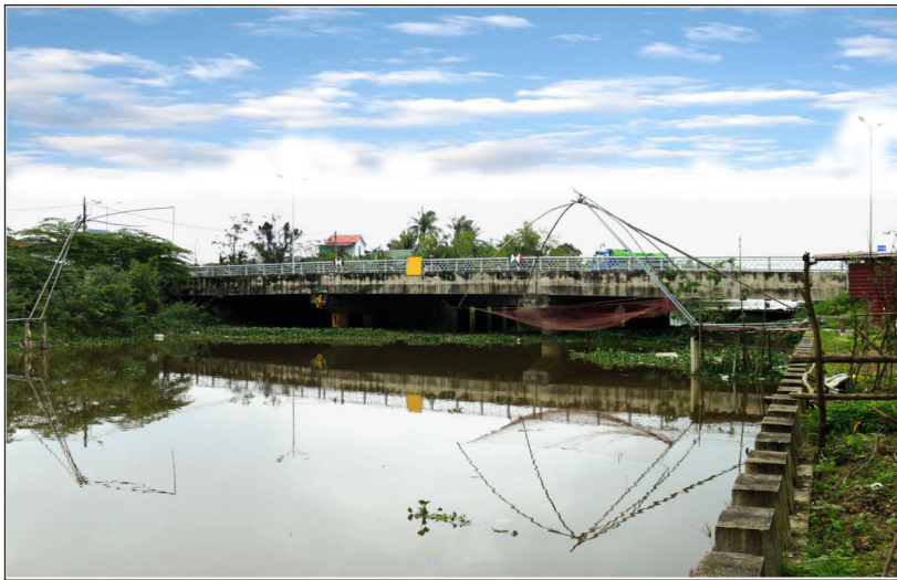
Cầu Lợi Nông bắc qua sông An Cựu trên quốc lộ 49. Những cây cầu mới xây trên sông An Cựu đều có độ tĩnh không thông thuyền thấp, gây cản trở tàu thuyền qua lại. Đây là một trở ngại lớn cho viễn cảnh mở các tour du lịch sinh thái trên sông An Cựu.
