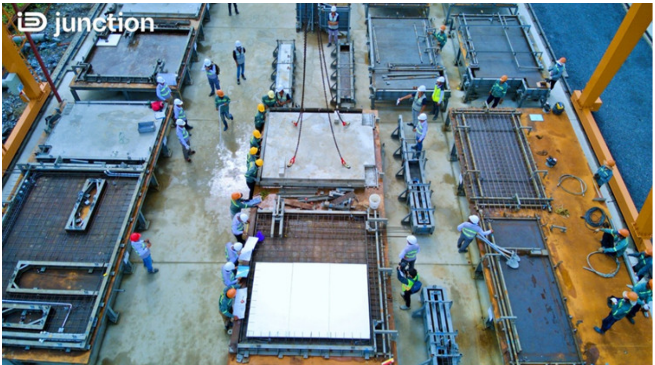
Hình 2. Toàn cảnh tháo khuôn thành phẩm cấu kiện precast tại dự án iD Junction vào tháng 6/2022
