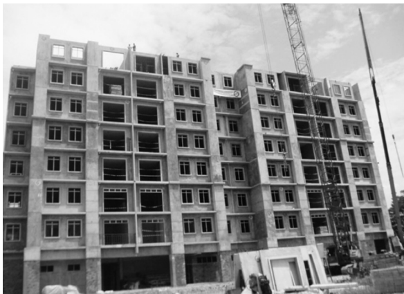
b) Kết cấu nhà cao tầng khung bê tông lắp ghép kết hợp lõi vách Hình 1. Khung bê tông lắp ghép được ứng dụng trong kết cấu công trình [2- 4]
