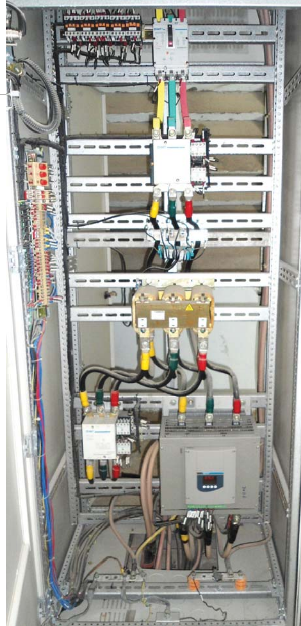
Tủ khởi động mềm cho động cơ hạ thế nhằm góp phần giảm lượng điện năng tiêu thụ (Xi măng Yên Bình)
