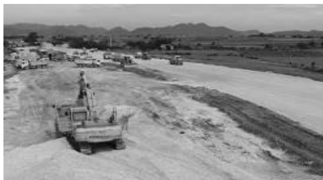
Hình 1. Công trình bị chậm tiến độ do bố trí mặt bằng thi công chưa phù hợp
