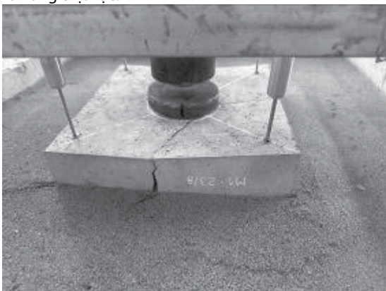
Hình 7. Vết nứt do tải trọng tập trung tác dụng trên tấm BTCLTC
