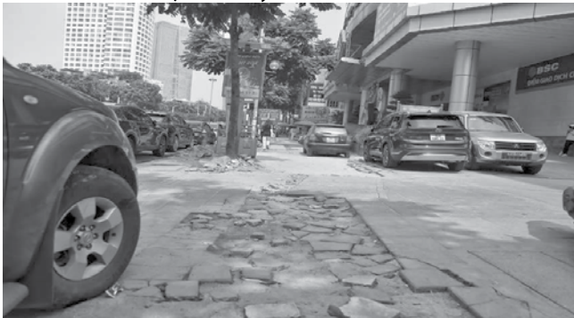
Hình 1. Vỉa hè bị xuống cấp trên phố tại Hà Nội
