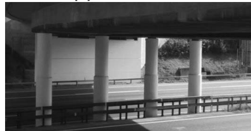
Cầu Grafstal Bridge ở Thụy Sĩ, trụ cầu hình tròn được gia cường bởi lớp UHPC [7]
