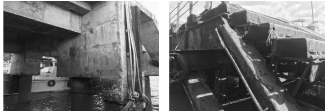
Hình 1. Ăn mòn công trình BTCT tại các công trình ven biển khu vực Kiên Giang.
