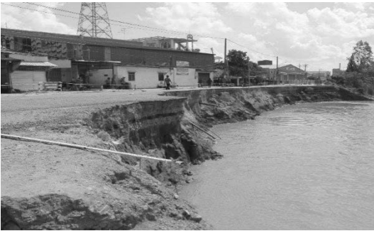
Hình 1. Minh họa tình trạng sạt lở tuyến đường ven sông tại huyện Trà Cú, tỉnh Trà Vinh, một trong những khu vực chịu ảnh hưởng nghiêm trọng của hiện tượng này (nguồn: Công Mao-TTXVN, 2019).
