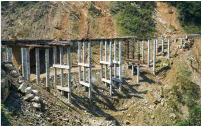
Quá trình xây dựng công trình tại cầu Eo Cô Gái trên Quốc lộ 8A, sử dụng giải pháp cầu nhịp ngắn trên mố, trụ dèo để xử lý điểm đen về sạt trượt.
