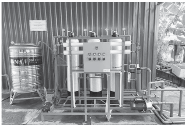
Hình 5. Hệ thống khử mặn công suất 200 L/h
