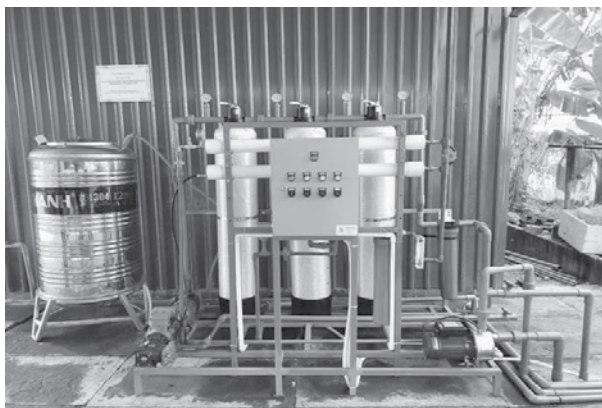
Hình 5. Hệ thống khử mặn công suất 200 L/h
