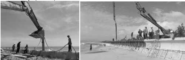
Hình 14. Hạ cọc bê tông cốt thép bằng xối nước và đổ tại chỗ mũi hất sóng tại cao trình cao hơn mực nước biển
