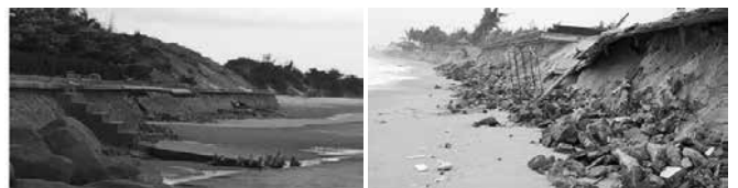
Hình 2. Kè xây đá học tại bờ biển khu nghỉ dưỡng Long Cung và Sao Việt Non Nước
