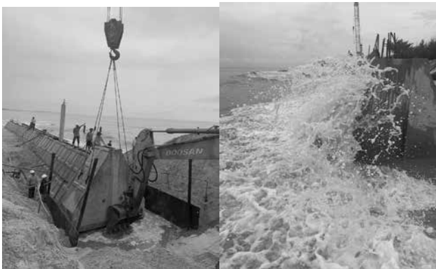
Hình 14. Thi công kè bảo vệ bờ tại bờ biển khu du lịch Lăng Chài - tỉnh Bà Rịa - Vũng Tàu
