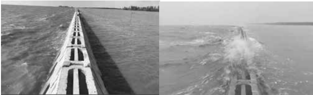
Hình 15. Kè giảm sóng dạng chữ A tại biển Tây - Cà Mau
