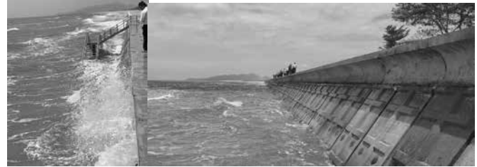
Hình 17. Kè bảo vệ bờ biển bị xói lở tại khu du lịch Lăng Chài - tỉnh Bà Rịa - Vũng Tàu
