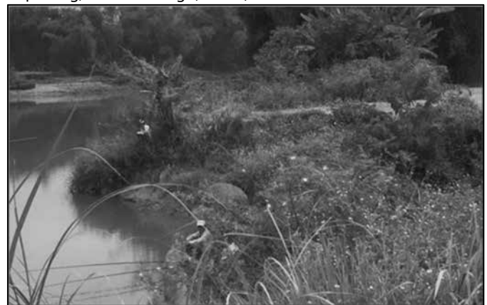
Hình 2: Hiện trạng sạt lở khoảng 20m bờ sông khu vực xã Hòa Phong
