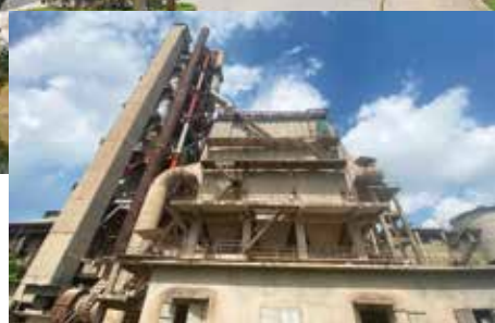
Hệ thống lọc bụi tĩnh điện cũ của Nhà máy Xi măng Yên Bái được thay thế bằng hệ thống lọc bụi túi công nghệ mới của châu Âu.
