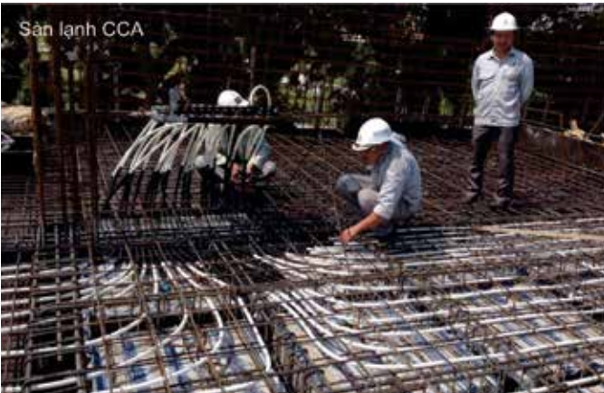
Hệ thống sàn lạnh CCA, sử dụng địa nhiệt để hỗ trợ cho nhu cầu làm mát, sưởi ấm của công trình
