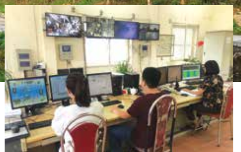
Trung tâm vận hành, điều hành trung tâm của Nhà máy Xi măng Yên Bái.
