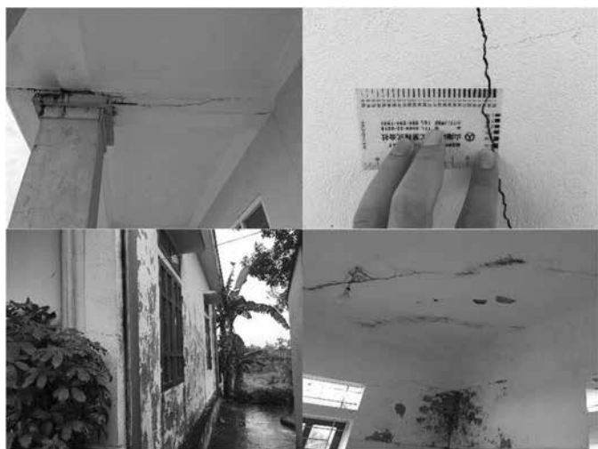
Hình 2. Một số hình ảnh hư hỏng và xuống cấp công trình ven biển Hà Tĩnh do nhóm nghiên cứu khảo sát
