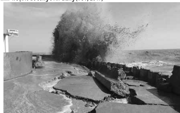
Hình 5. Sạt lở tại kè đê biển Gành Hào, Bạc Liêu (Bảo Thanh Niên, 2017)
