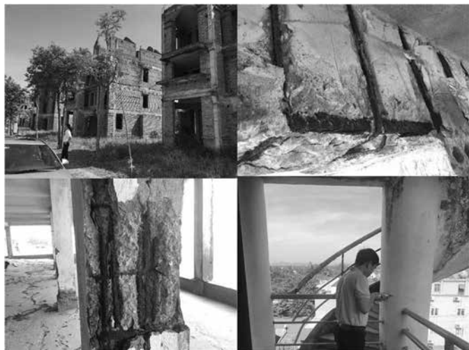
Hình 1. Một số hình ảnh hư hỏng công trình ven biển Nghệ An - Hà Tĩnh do nhóm nghiên cứu khảo sát
