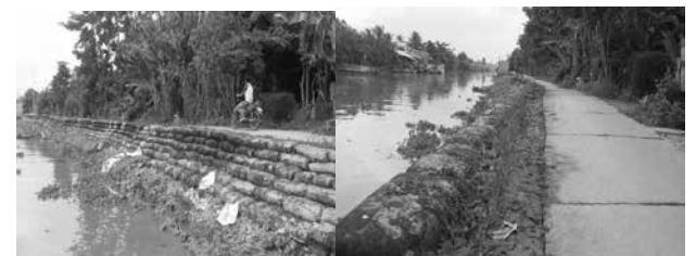
Hình 5. Bờ kè mềm BST Kè chống sạt lở kênh Mỹ Hạnh Bắc, Cái Bè, tỉnh Tiền Giang
