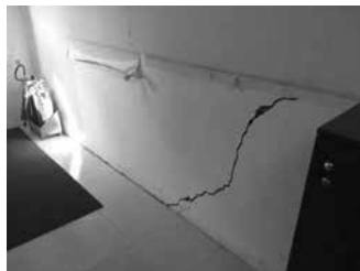
Hình 4. Tường nhà phố bị nứt do hiện tượng lún ướt của đất nền gây ra
