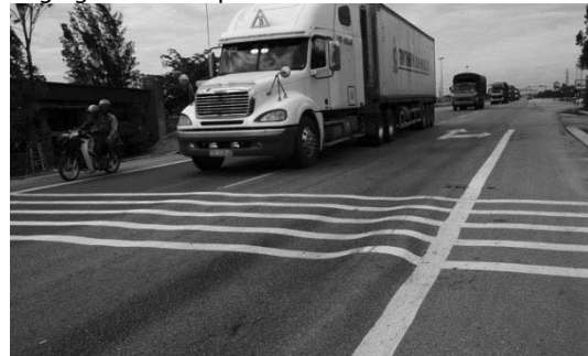
Hình 1 - Hẳn lún vệt bánh xe dưới tác dụng của tải trọng trùng phục [Nguồn Báo Giao thông - Bài báo "Bê tông nhựa loại thường không phù hợp nắng nóng miền Trung" - 28/06/2015]
