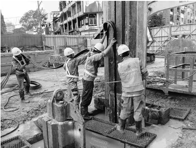
Công ty Bachy Soletanche Việt Nam thực hiện công tác lắp đặt giăng ngăn nước (CWS) cho tường vây.
