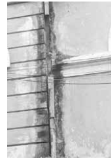
Hình 12. Ống nước nứt vỡ [1]
