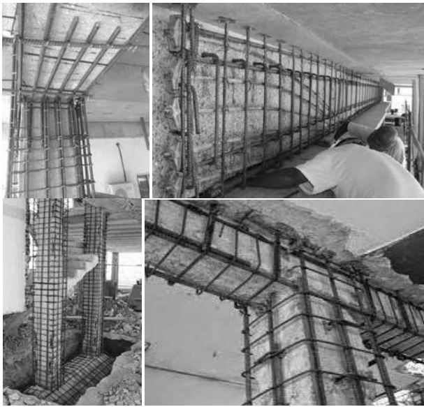
Hình 6. Tăng cường tiết diện dầm và cột của công trình Đối với bê tông có thể sử dụng 2 biện pháp thi công như sau: - Ghép ván khuôn và bơm (rót) bê tông vào trong. - Phun bê tông và thực hiện xoa phẳng bề mặt.
