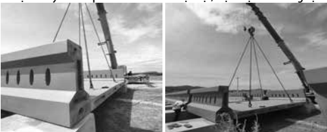
Hình 18. Cầu xếp các phân đốt dầm vào vị trí căng cáp (dự ứng lực căng sau có bám dính)
