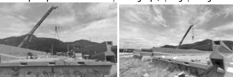
Hình 19. Căng cáp dự ứng lực và sử dụng keo Epoxy kết dính các phân đốt
