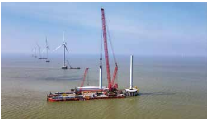
HTL dựng lắp 24 trụ turbine gió tại Dự án điện gió Tân Phú Đông, tỉnh Tiền Giang.
