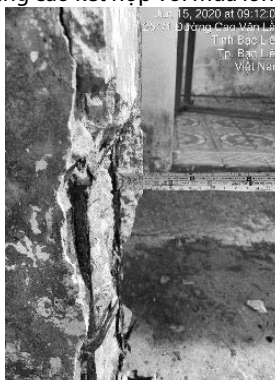
a) Cột bê tông cốt thép bị phá hủy
