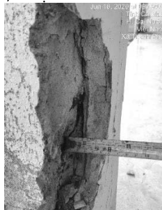
b) Vị trí nứt vỡ do cốt thép bị ăn mòn
