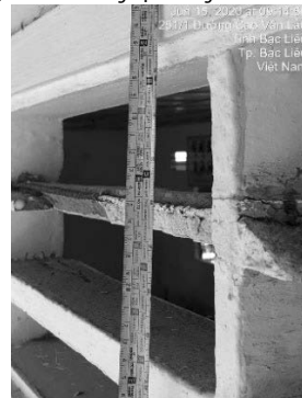
d) Chi tiết cửa thông gió bị phá hủy do ăn mòn cốt thép
