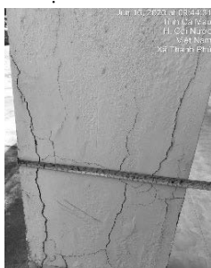
a) Nứt chân cột do cốt thép bị phá hủy
