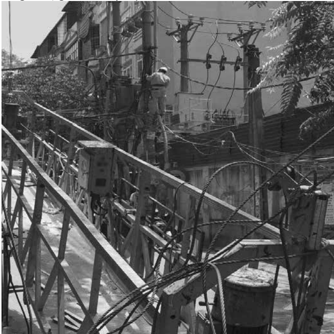
Hình 1. Hiện trường sự cố một dây cáp của sàn treo xây dựng bất ngờ đứt trong lúc 2 công nhân đang thi công ngoài trời trên sàn treo ở tầng 6, sàn treo rơi xuống đường khiến 2 người bị thương nặng phải nhập viện cấp cứu năm 2018 ở Hà Nội.
