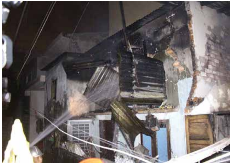
Hình 2. Cháy làm đổ sập hoàn toàn căn nhà của người dân.
