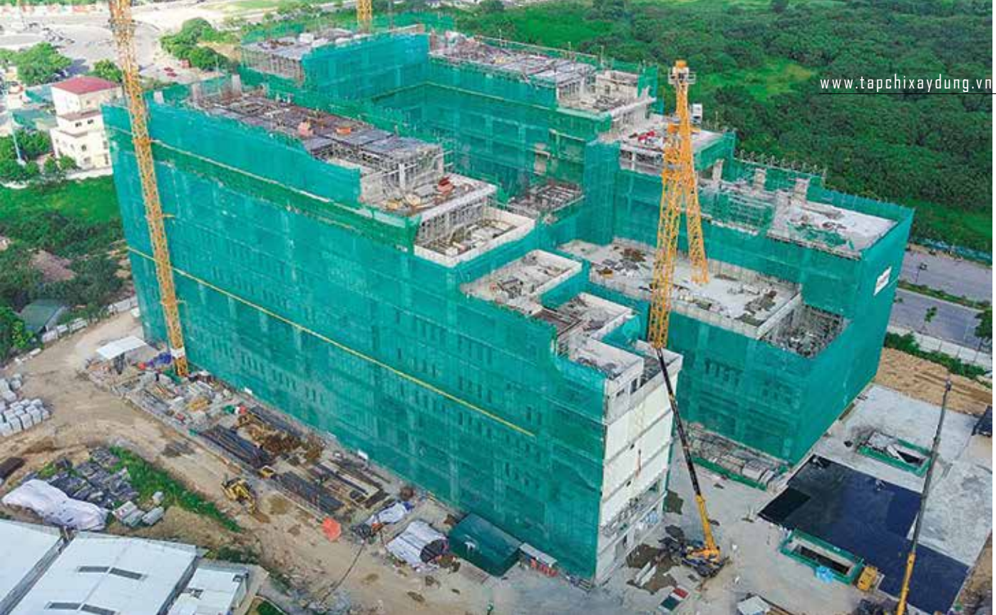
Dự án Bệnh viện An Sinh Hà Nội được áp dụng BIM triệt để trong thi công cơ điện.
