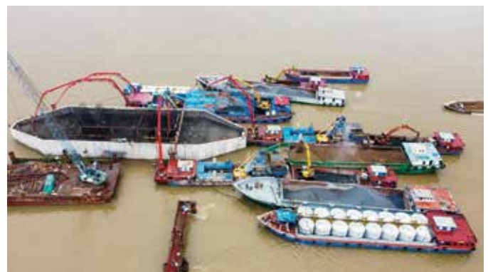
Hệ thống 03 hệ thống trạm trộn cấp 2.000 m 3 bê tông cho bê trụ cầu Mỹ Thuận 2 trong thời gian <10 h.
