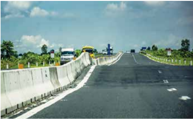
Hình 10. Các hư hỏng, lún mặt đường Lộ Tê - Rạch Sỏi do GS.TSKH Nguyễn Ngọc Trân chụp.
