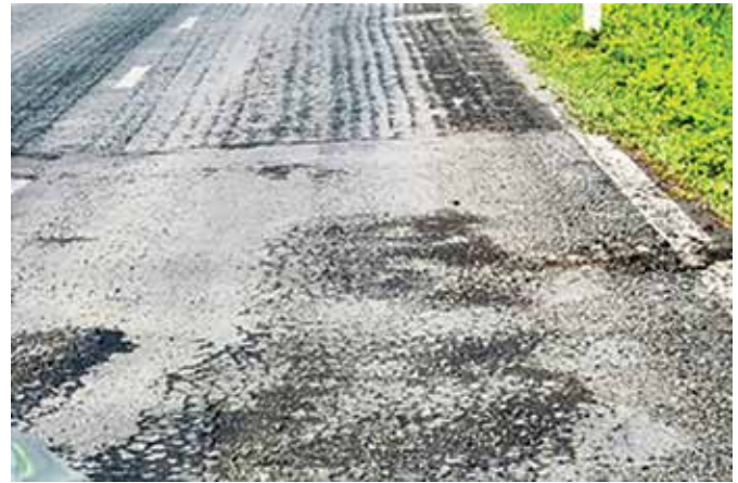
Mặt đường vừa được sửa chữa đã bong trở lại.
