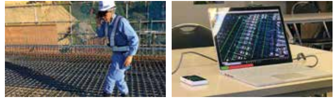
Hình 6. Kỹ sư đang sử dụng kính HoloLens để kiểm tra độ chính xác của việc đặt cốt thép (Hình ảnh tham khảo từ tài liệu giới thiệu sản phẩm của Công ty Informatix Inc.).
