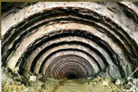
Ống hầm H2 đã được đơn vị thi công đào được 270/290 m.
