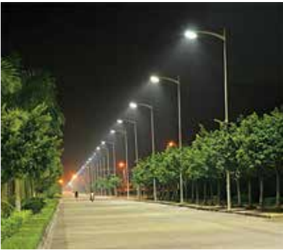
H1. Chiếu sáng đường phố.
