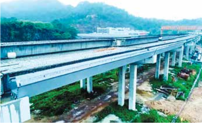
Công ty ZhongLu-DURA đã xây dựng cầu cạn đường cao tốc từ Trung Sơn đến Khai Bình ở Trung Quốc. Tải trọng đường cao tốc hạng nhất (JTG D60-2015).
