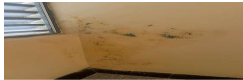
Hình 3.19. Khu vực tiếp giáp nền tường và cầu thang tầng 3-4 khoa Y Dược
