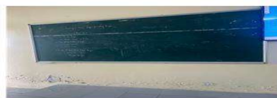
Hình 3.14. Bong tróc tại nền tường phòng học giảng đường nhà B
