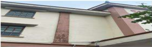
Hình 3.6. Nứt tại tường cột đứng nhà hiệu bộ A
