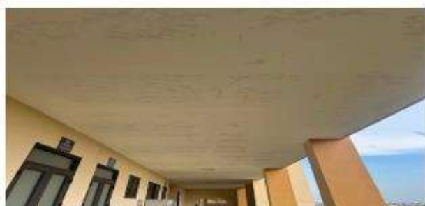
Hình 3.15. Trần hành lang khoa Y Dược nhà C bị loang ố ẩm mốc
