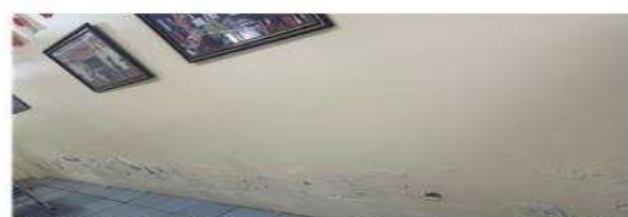
Hình 3.12. Chân tường phòng học nhà B bị ẩm mốc loang màu thấm nước
