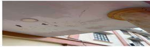
Hình 3.7. Vết nứt sâu và loang lổ tại mái hiên sảnh nhà hiệu bộ A
