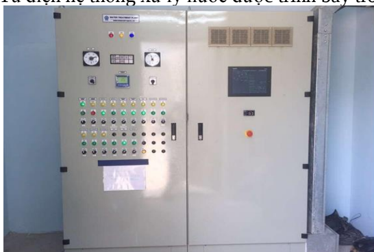
Hình 2. Tủ điện hệ thống xử lý nước
