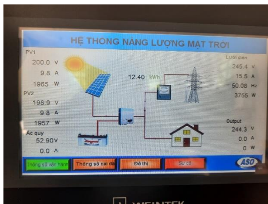
Hình 7. Giao diện HMI của hệ thống điện mặt trời 5 kW hòa lưới có lưu trữ
