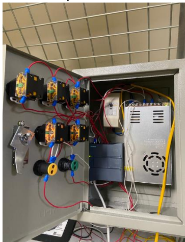
Hình 14. Đầu nối và vị trí các thiết bị trong tủ điện
