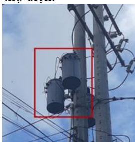
Hình 1. MBA phân phối đang được vận hành trên lưới điện
