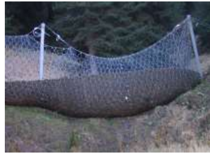
Hình 4: Hệ thống lưới thép linh hoạt đầy bùn đất [5].
