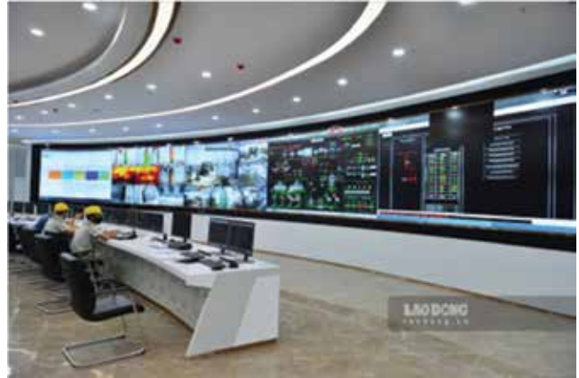
▲ Phòng điều hành của Nhà máy đốt rác phát điện Thiên Lý, Sóc Sơn, Hà Nội
