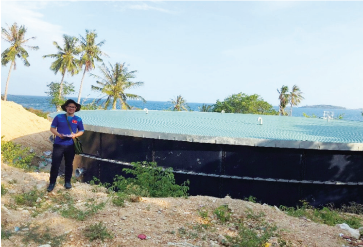
Hình 2. Bể nước ngọt dung tích 2.800 m 3 trên hòn Ngang của xã đảo Nam Du
