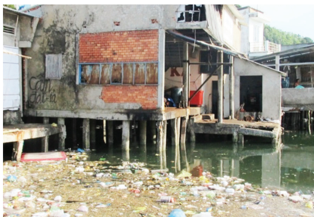
Hệ thống nước thải năm 3/2018
