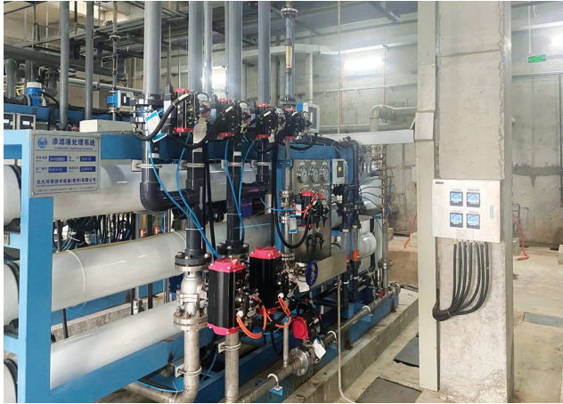
Hệ thống thiết bị siêu lọc, xử lý nước thải khép kín của Nhà máy điện rác Hậu Giang
